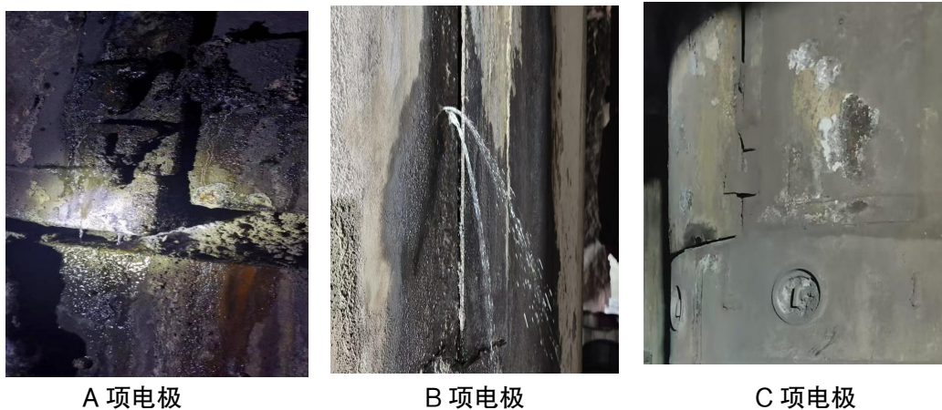
图 4 2#矿热炉电极漏水示意图
