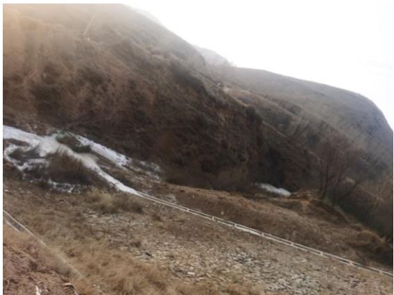
排水棱体区域大坝渗漏现状
