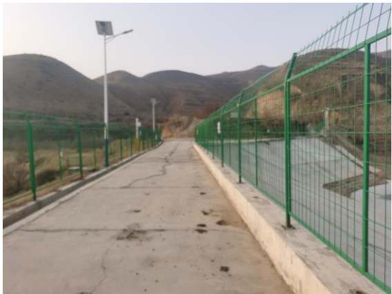
水库坝顶裂缝现状
