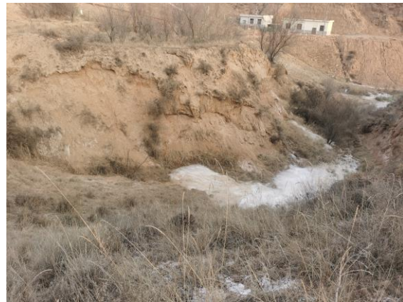
大坝坝体渗漏现状（坝下）
