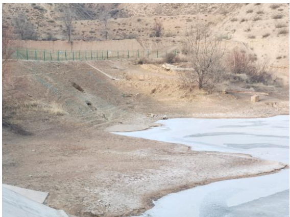
右岸坝坡坍塌现状
