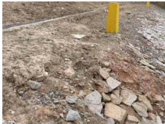
下游坝坡侵蚀冲坑现状
