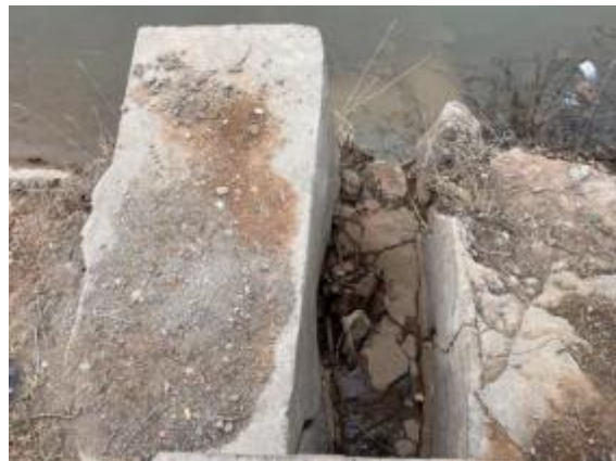
入库陡坡末端损毁现状
