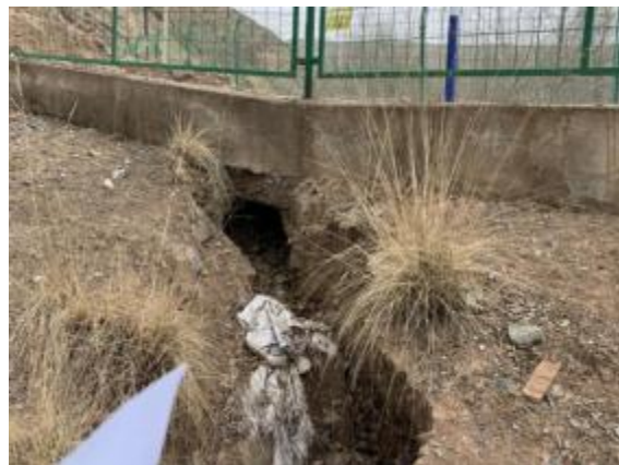
左坝肩坡面水入库孔冲沟现状
