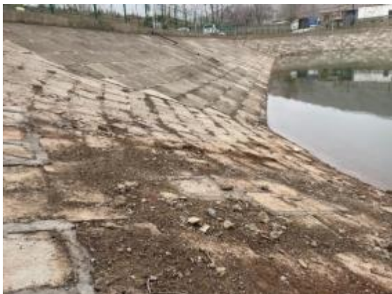
上游预制块护坡局部酥化脱落现状
