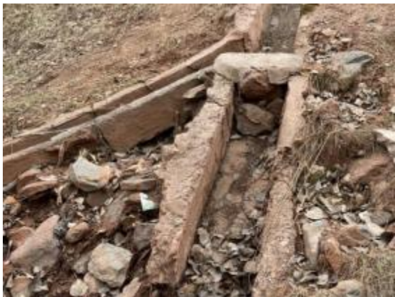
排水沟破损现状
