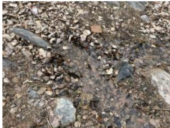
坝后渗漏现状
