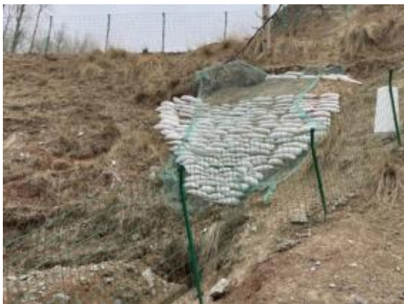
下游坝坡塌陷（近左坝肩）现状
